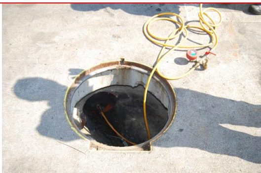
5. Kanal odtočnega jaška se zapre z balonom, s katerim se v jašku zapolni odtočna cev in prepreči iztok odpadne tekočine naprej v kanalizacijo.
